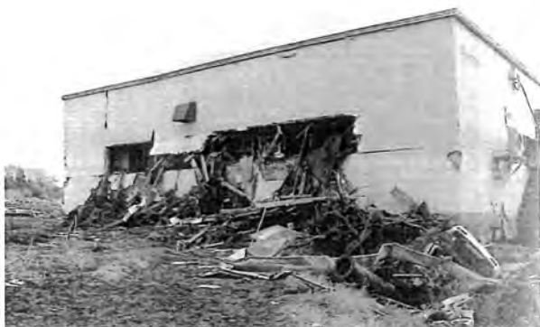
写真1 基礎ごと流出した七ヶ浜交換局
