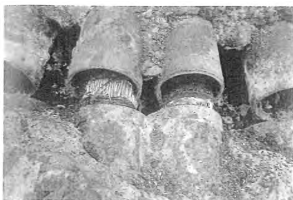
写真2 管路の破損（ケーブル露出）
