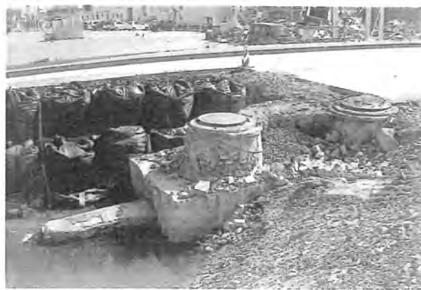
写真5 MH首部の露出
